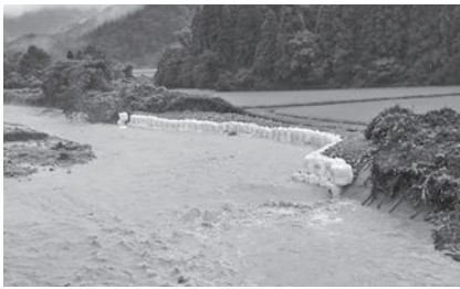
河川氾濫でえぐれた堤防(仁田山橋上から)
